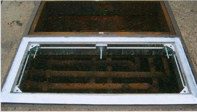
Ohne Bauantrag wird mit der WAD III ES schnell und günstig saniert.
